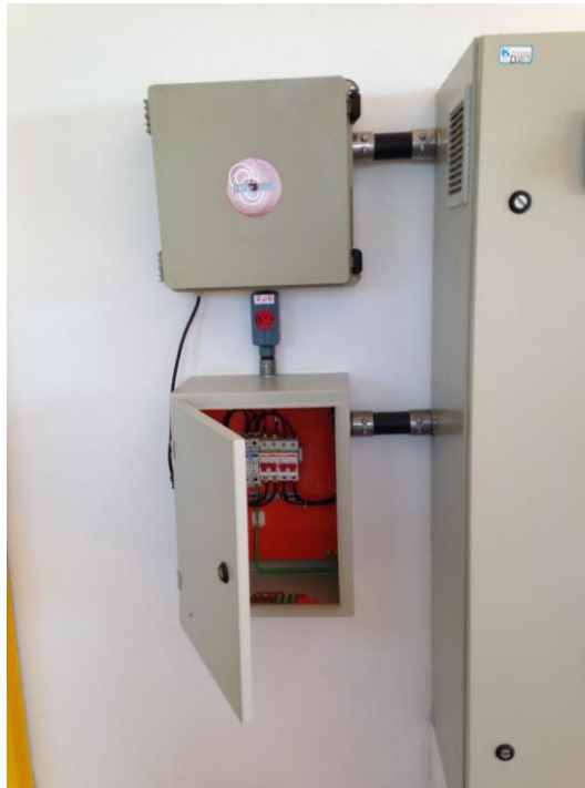
Foto do sistema de telemetria instalado junto a um painel.
