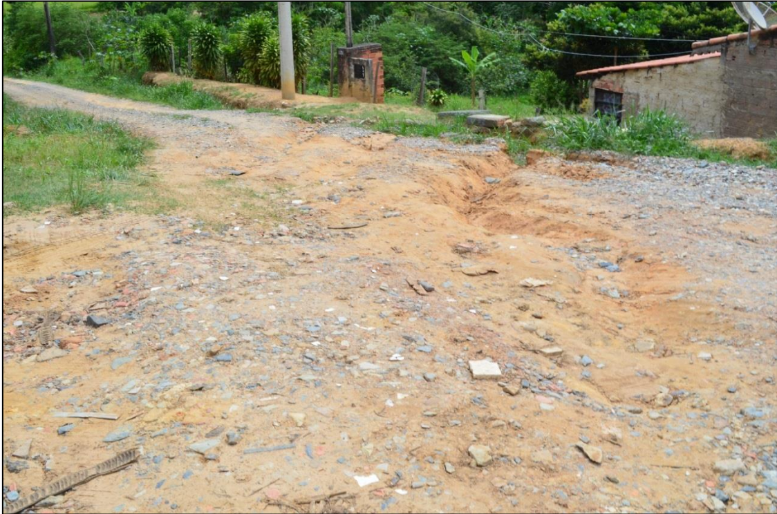
IMAGEM 3 - Rua sem pavimentação, nem guias, calçadas ou sarjetas, com erosão devido ocorrência de chuva.
