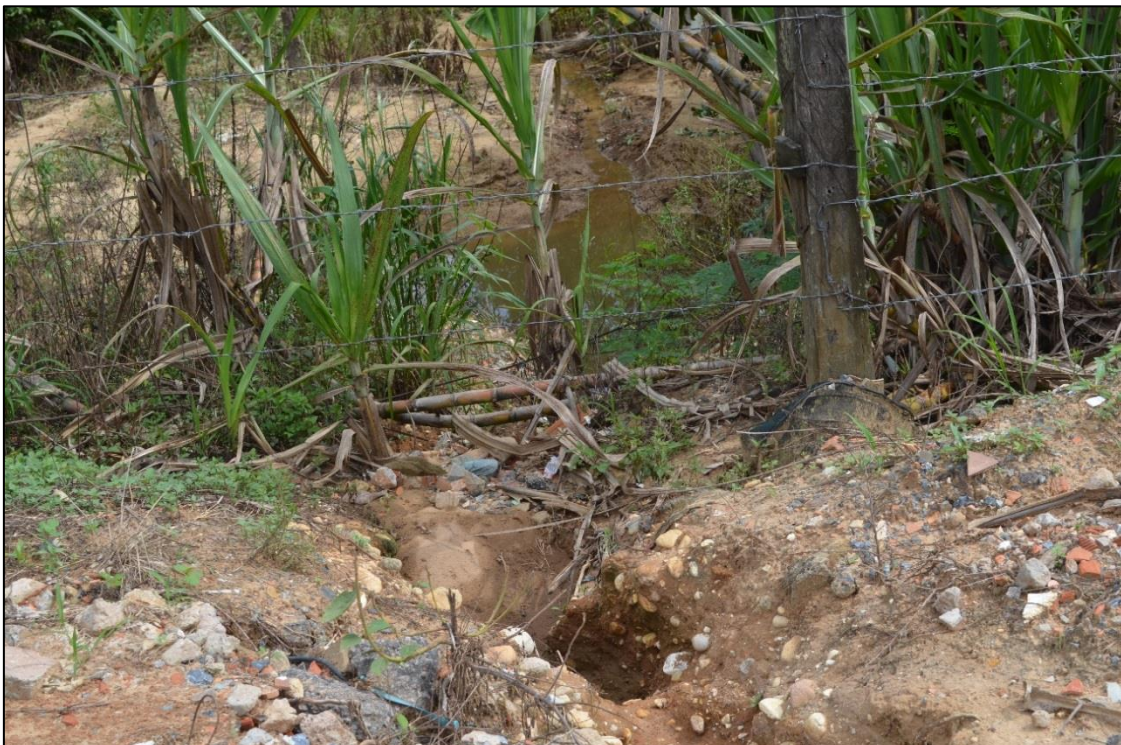
IMAGEM 8 - Córrego sem denominação que corta o núcleo. Ponto final do córrego no bairro, que recebe todo material carreado das vias públicas causadas pelas chuvas.
