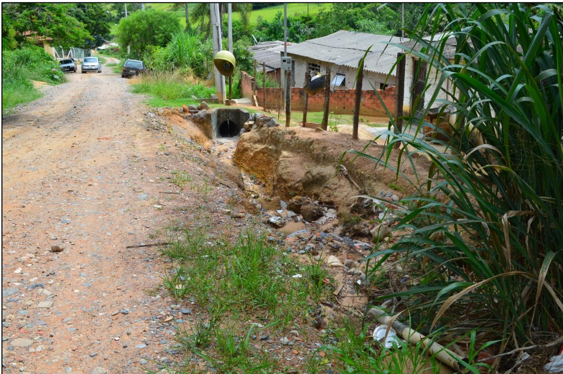
IMAGEM 2 - Rua sem pavimentação, nem guias, calçadas ou sarjetas. Há uma vala para escoamento de águas pluviais.
