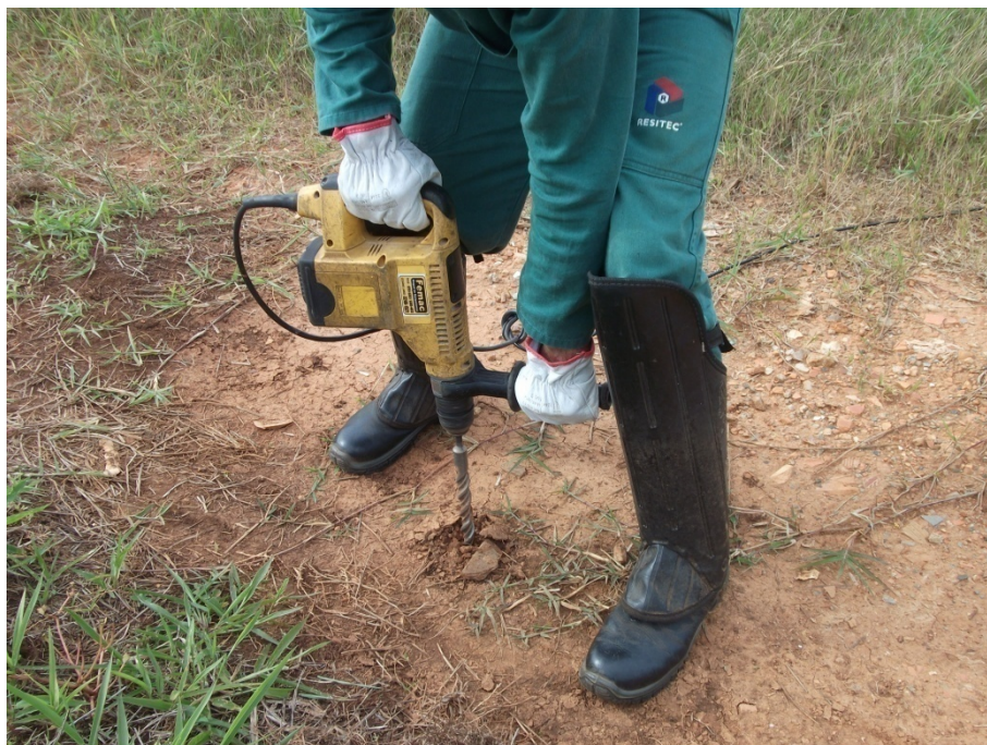
Figura 35 – Execução da perfuração com martetele para medição de gases no maciço de resíduos.
