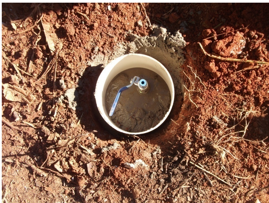
Figura 32 – Encerramento do poço de monitoramento de gases, observa-se a válvula de fechamento.
