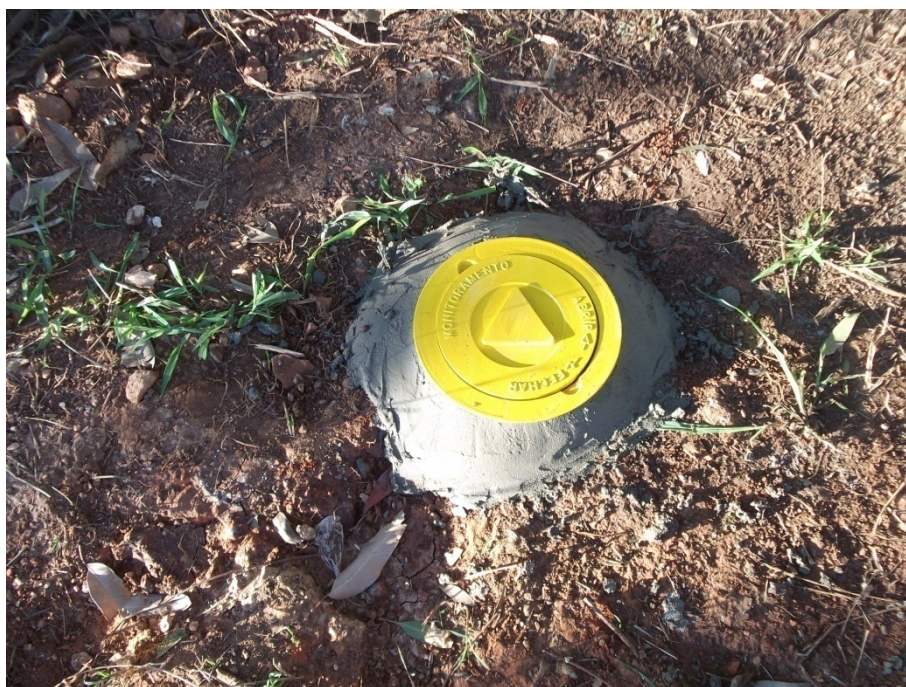
Figura 33 – Visualiza-se a tampa de proteção tipo calçada instalado no poço de monitoramento de gases.
