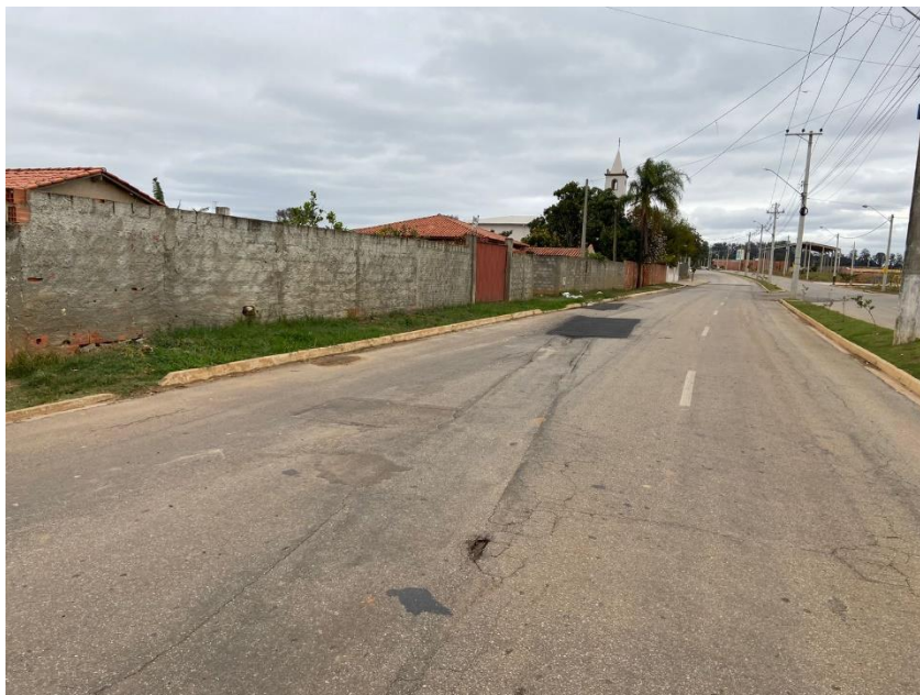
ESTRADA BRAZ JOÃO VIEIRA – TRECHO DA RUA A RECAPEAR.
