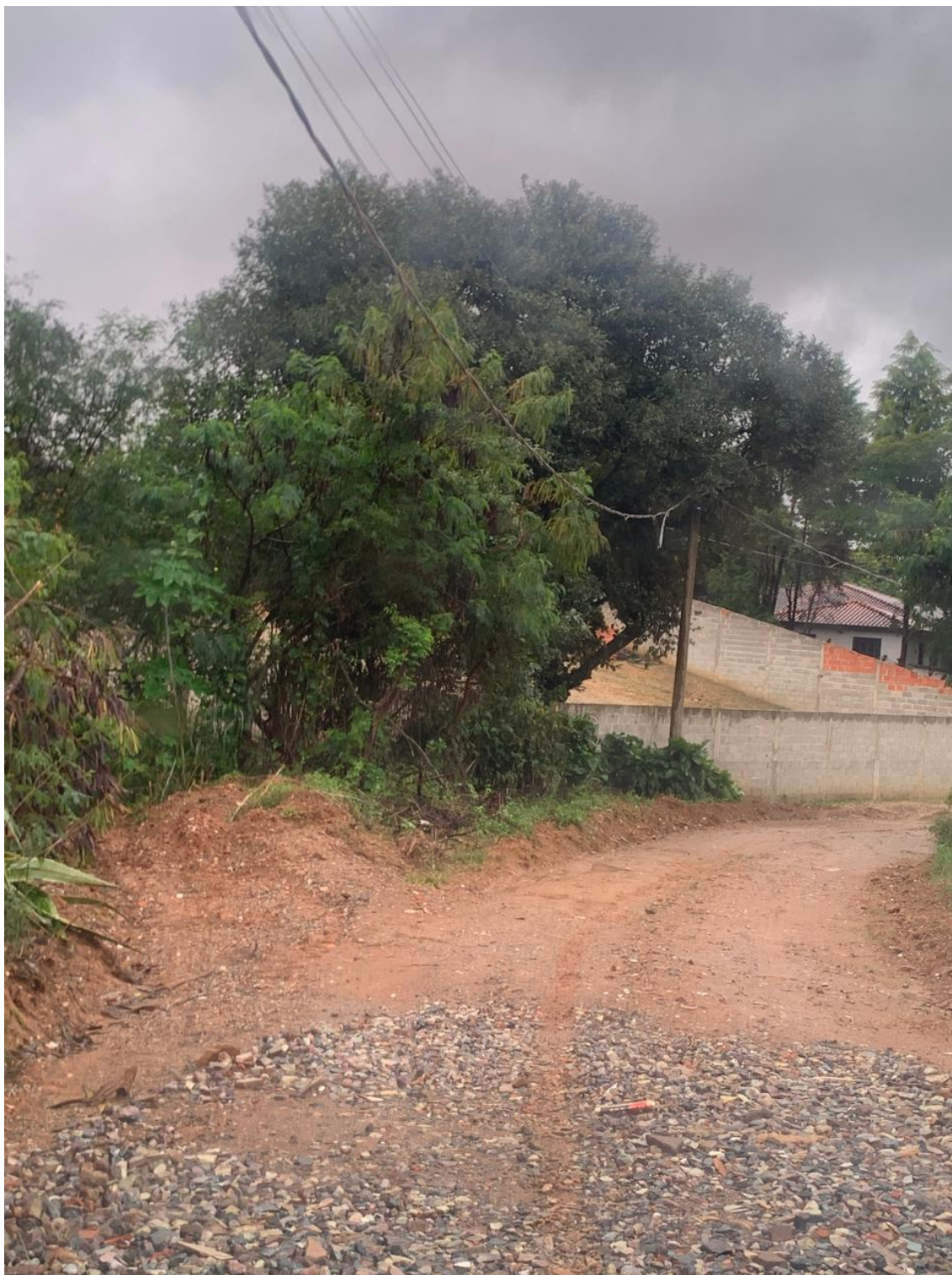
Imagem 9 - Rua sem pavimentação, nem guias, calçadas ou sarjetas. Há uma vala para escoamento de águas pluviais, com sangra na lateral para saída da água pluvial no corpo hídrico.
