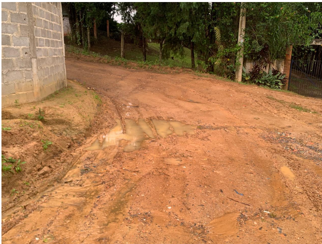
Imagem 10 – Trecho da via com presença de erosão e acúmulo de água – vista 1.
