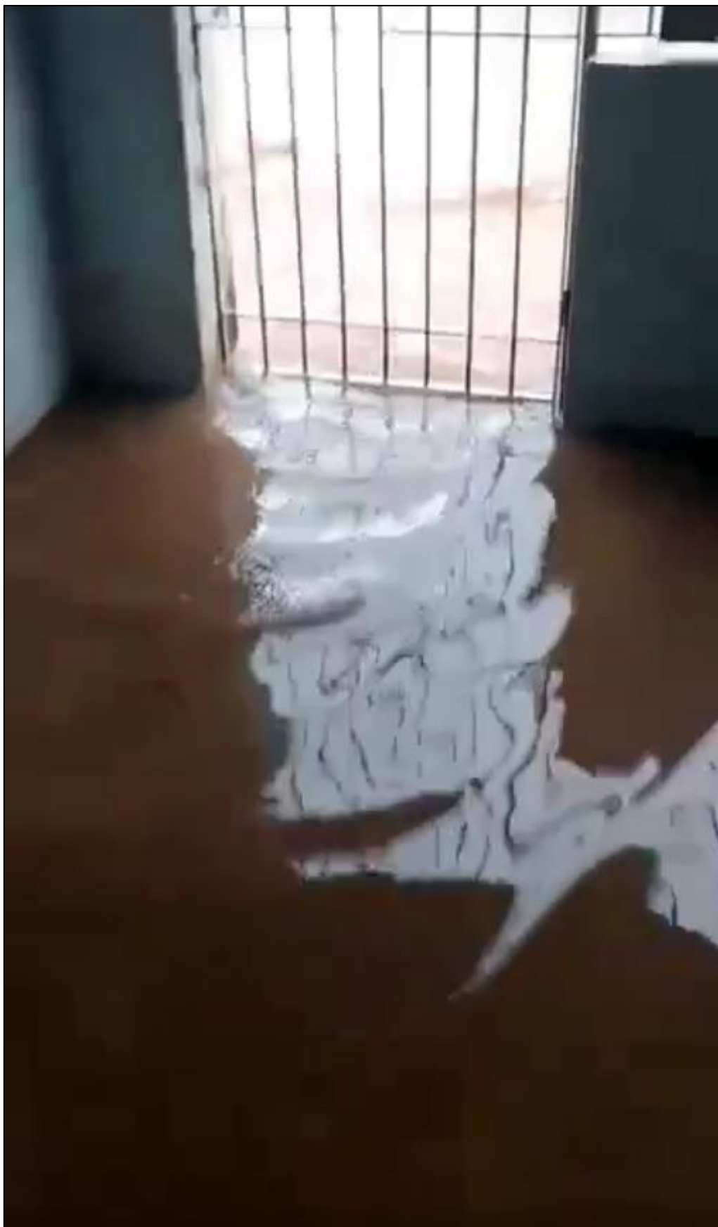
IMAGEM 11 - Garagem de munícipe residente na Rua Sete de Setembro invadida pela água da chuva – Vista 2 – chuva do dia 22 de novembro de 2022.
