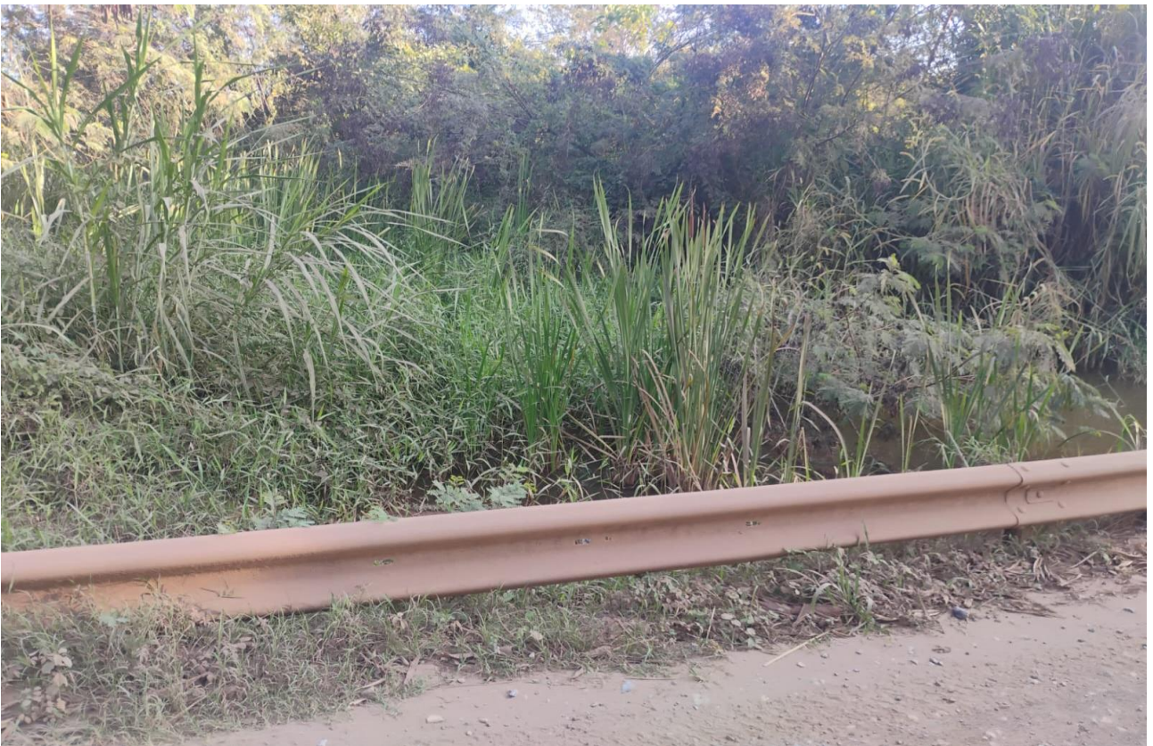
Passagem (montante) obstruídas
