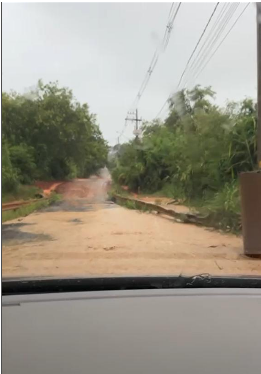
Imagem 10 - Ocorrência de alagamento no trecho da travessia – dezembro de 2024 – vista 1.
