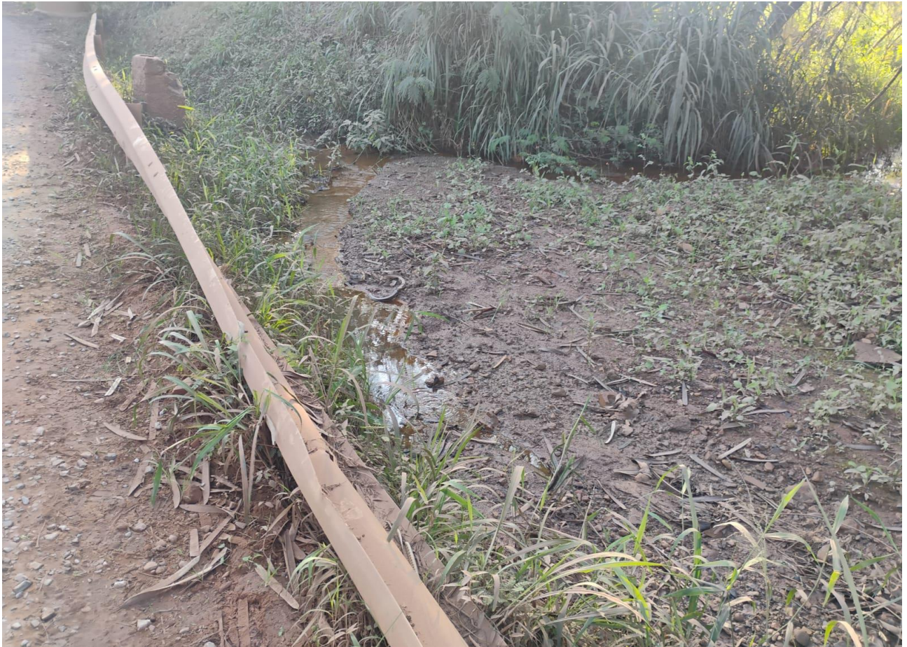
Passagem (jusante) obstruídas Vista Montante (Atual)
