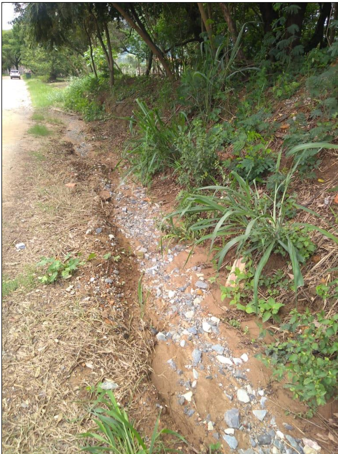
IMAGEM 15 - Rua sem pavimentação, nem guias, calçadas ou sarjetas. Há uma vala para escoamento de águas pluviais, a qual está cheia de sedimentos provenientes das erosões das estradas.
