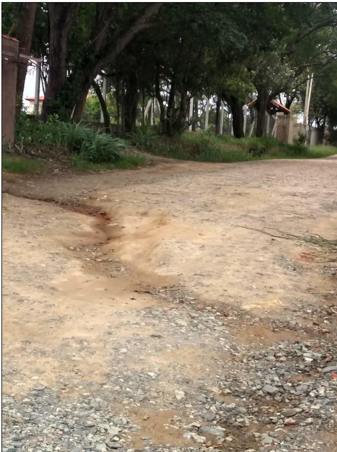
IMAGEM 9 - Rua sem pavimentação, nem guias, calçadas ou sarjetas. Há uma vala para escoamento de águas pluviais.
