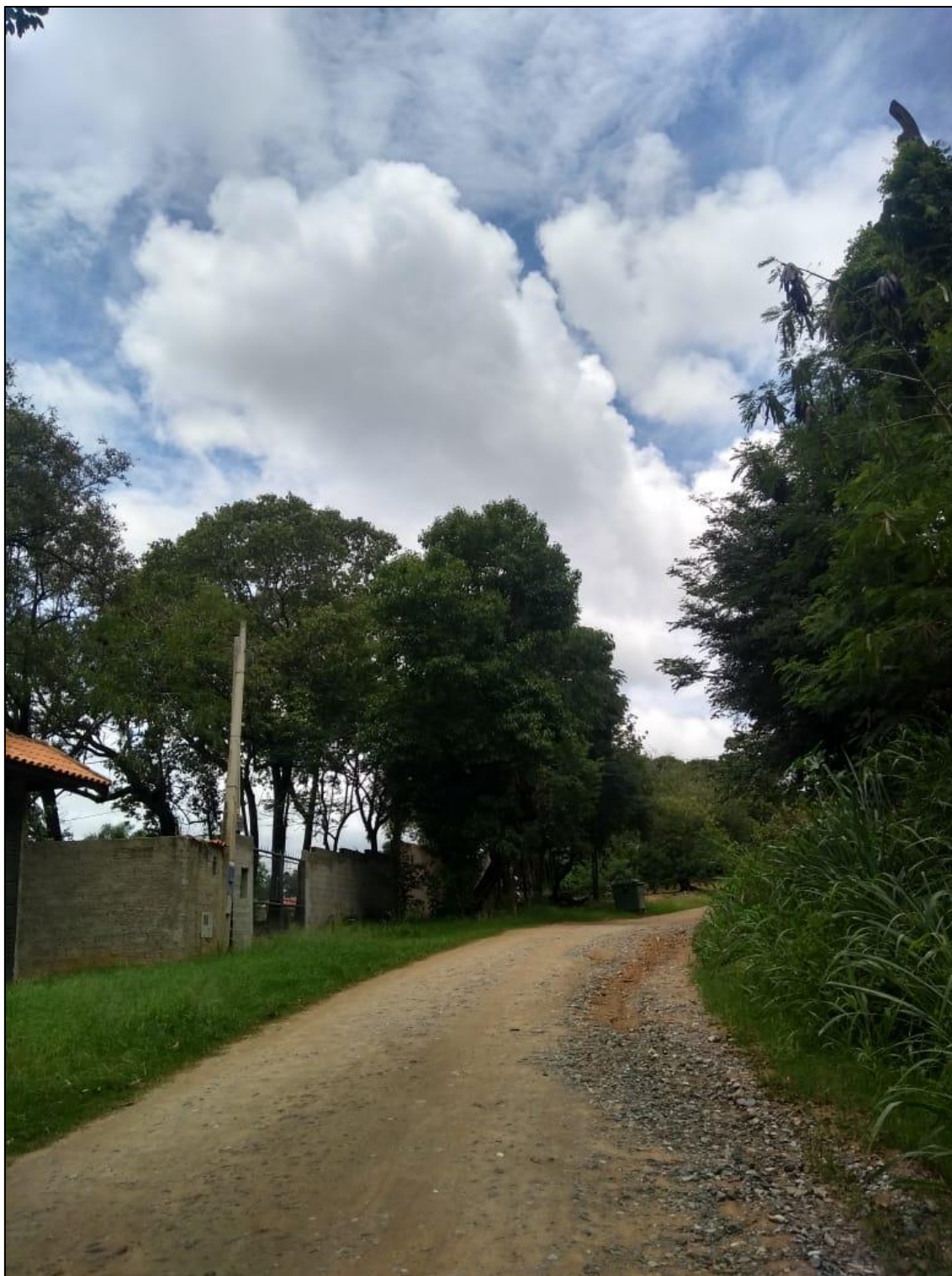
IMAGEM 12 - Rua sem pavimentação, nem guias, calçadas ou sarjetas, com erosão devido ocorrência de chuva.
