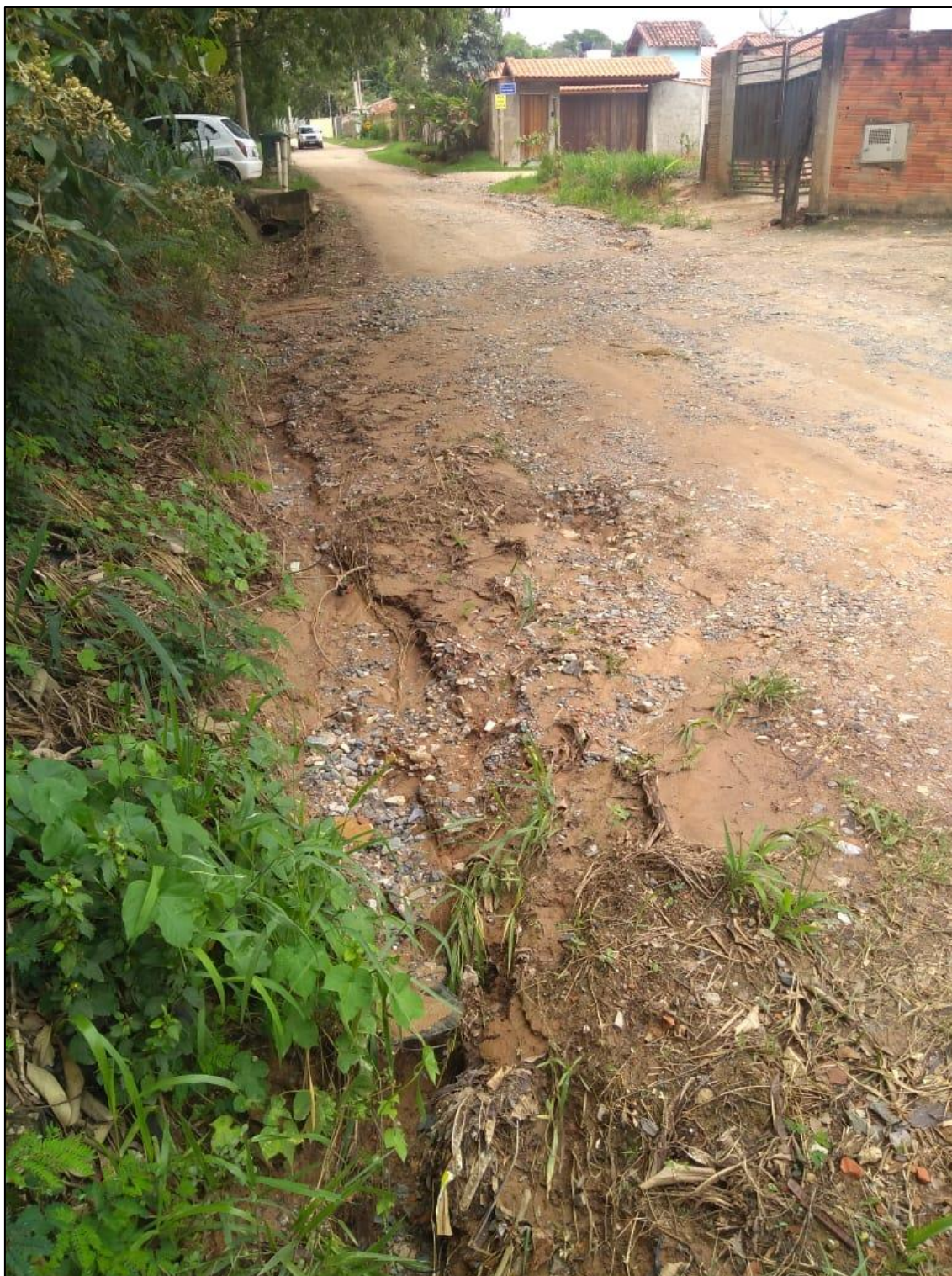
IMAGEM 13 - Rua sem pavimentação, nem guias, calçadas ou sarjetas. Há uma vala com tubo de passagem na saída da residência para escoamento de águas pluviais, as quais estão chias de sedimentos provenientes das erosões das estradas.
