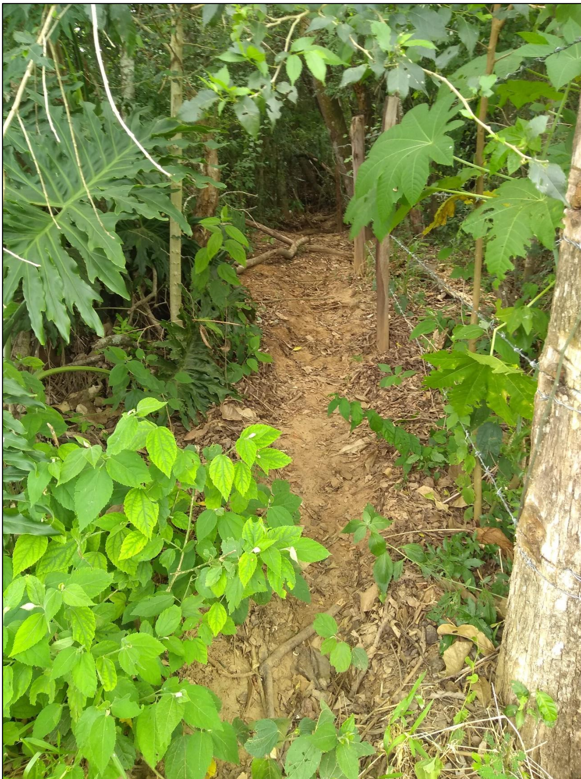
IMAGEM 8 – Ponto de descarga das águas pluviais no afluente do Rio Iperó.
