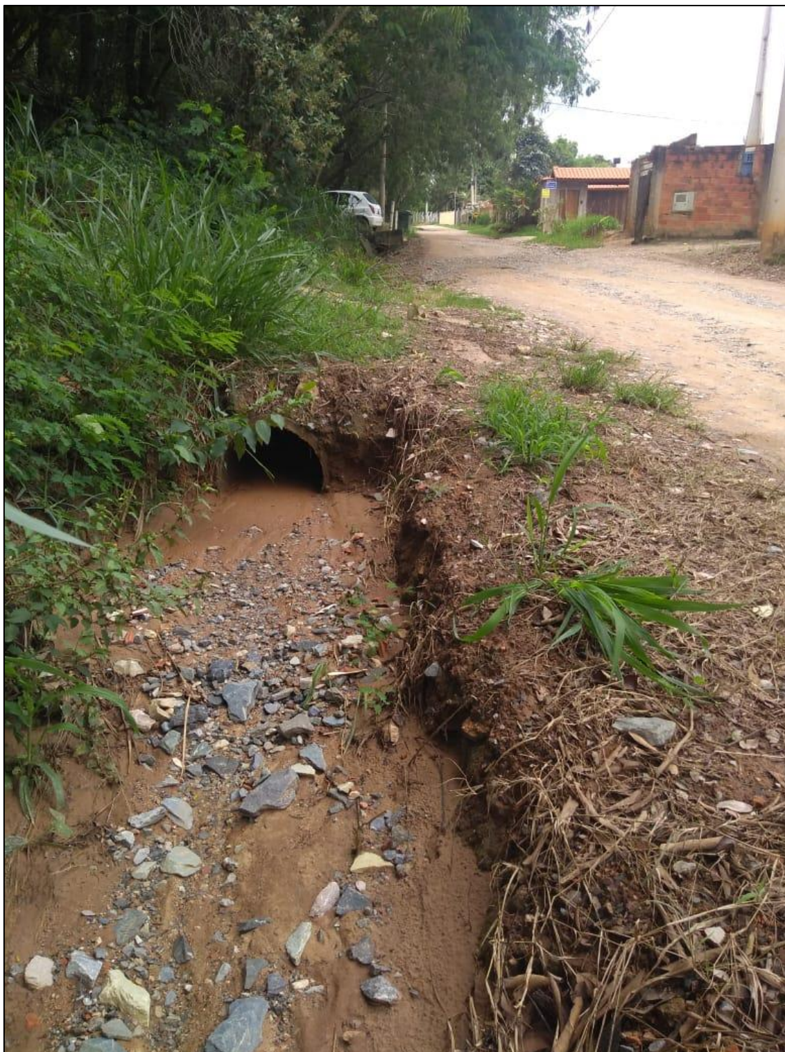
IMAGEM 14 - Rua sem pavimentação, nem guias, calçadas ou sarjetas. Há uma vala com tubo de passagem na saída da residência para escoamento de águas pluviais, as quais estão chias de sedimentos provenientes das erosões das estradas.
