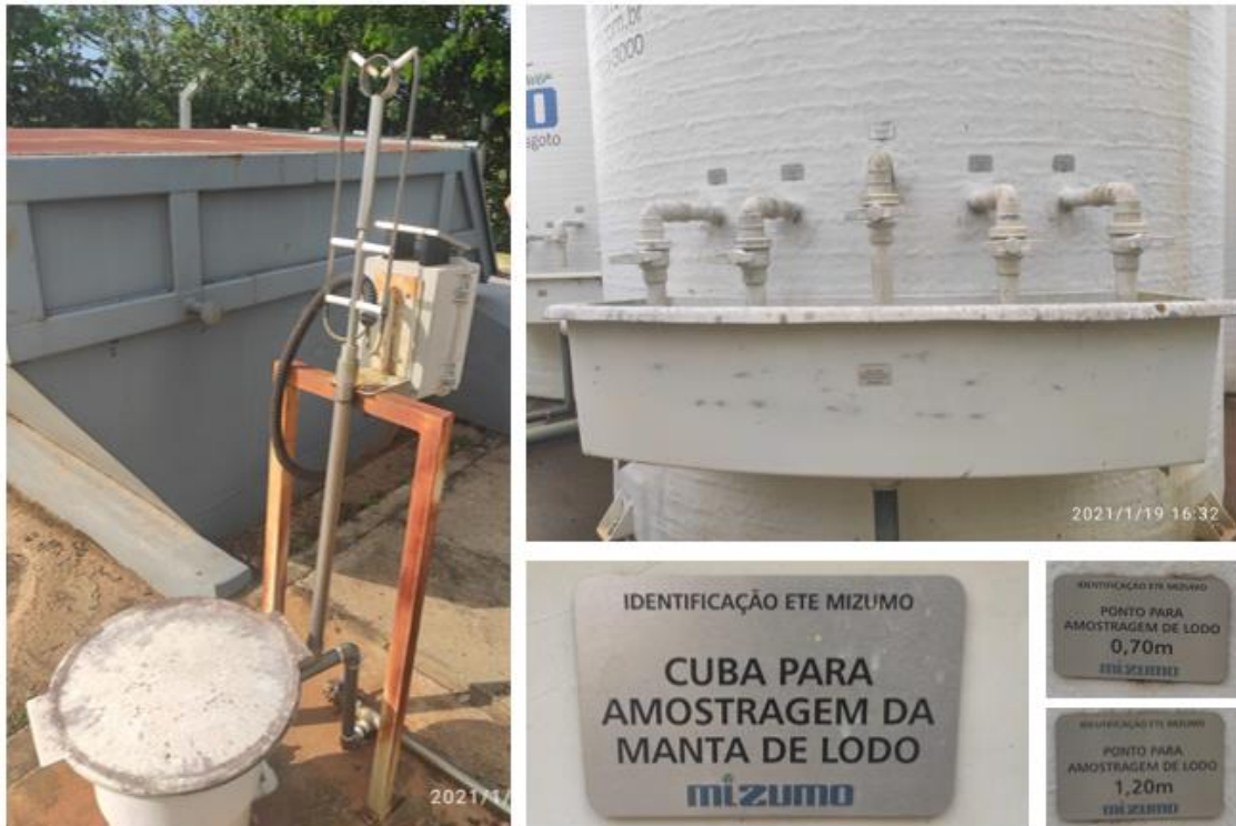
Figura 5-18 –Queima de gás e amostragem de lodo na ETE Porto Fonte: CONSÓRCIO CM (2021)
