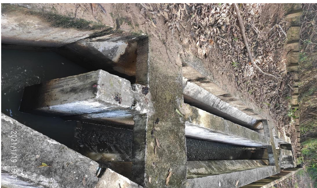
Figura 5-13 – Entrada de esgoto da ETE Capela do Alto Fonte: CONSÓRCIO CM (2021)
