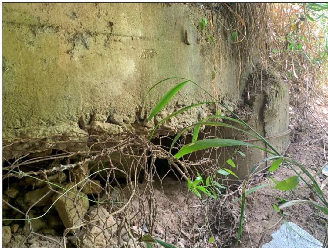
Imagem 19 - Travessia Rio Iperó - Vista inferior 7 – Sinais de erosão na base da travessia.
