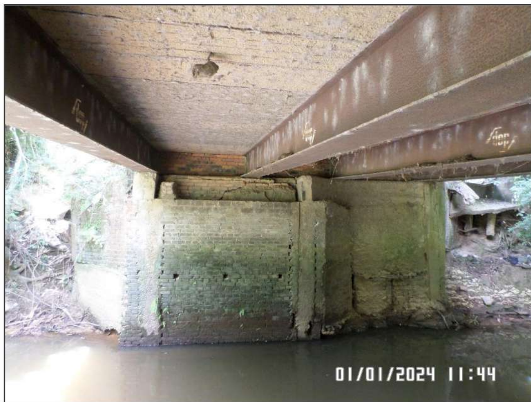
Imagem 16 - Travessia Rio Iperó - Vista inferior 4 – Base da travessia.
