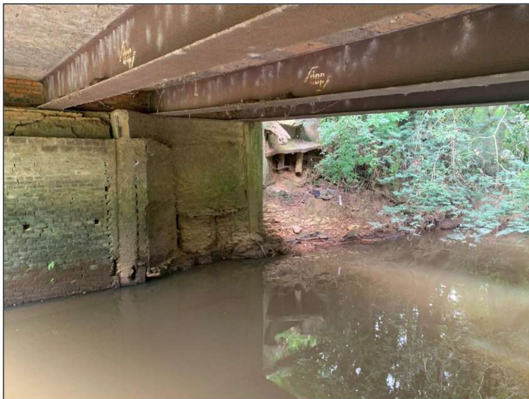
Imagem 15 - Travessia Rio Iperó - Vista inferior 3 – Base da travessia.
