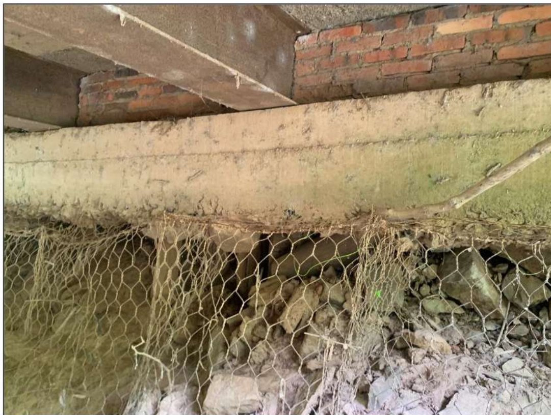
Imagem 18 - Travessia Rio Iperó - Vista inferior 6 – Base da travessia.
